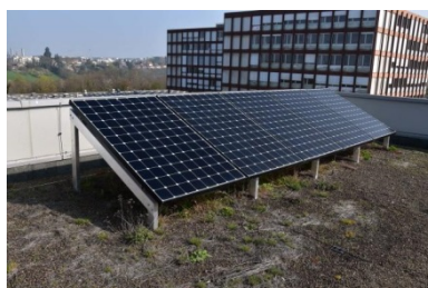
Panneaux photovoltaïques sur la toiture du DIP à Onex
